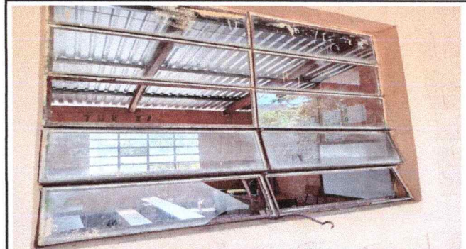
Foto 2: Reparacion de ventanas del establecimiento se observa en mal estado
