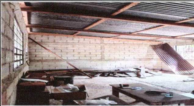
Foto 3: Se Observa el deterioro del techo, necesita cambio del techado
